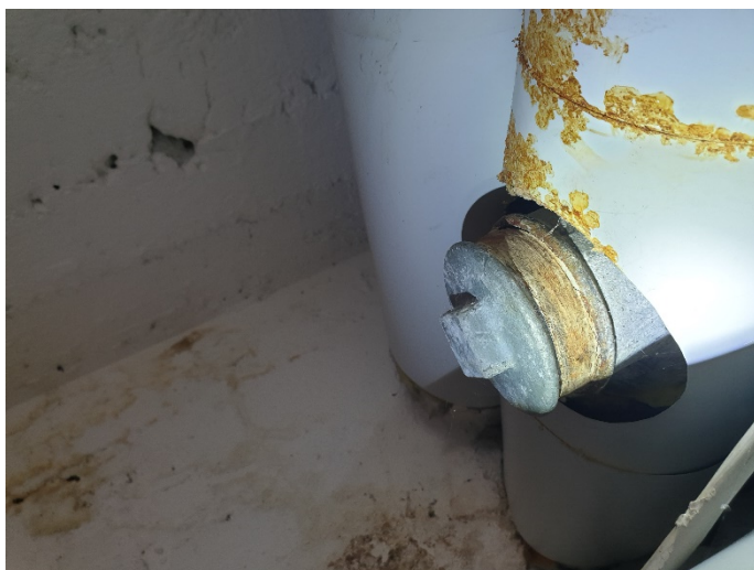
Läckande KV-ledning i krypgrund
