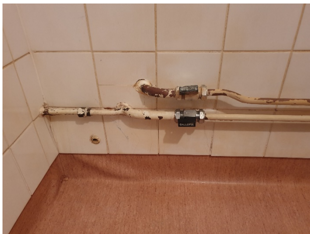
Rörgenomföringar nedtill i våtzone 1
