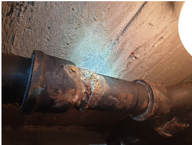
Avloppsrör i kryppgrund
