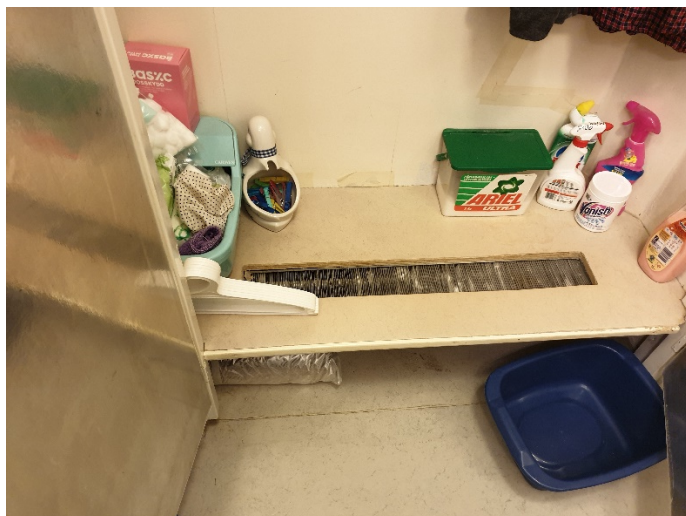
Värmeelement i badrum
