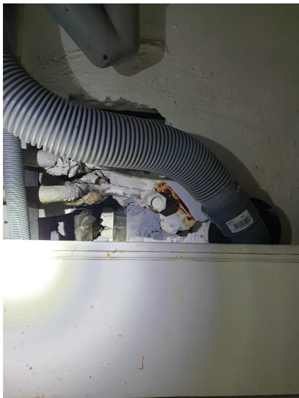
Osäkra rörskarvar, obefintlig isolering
